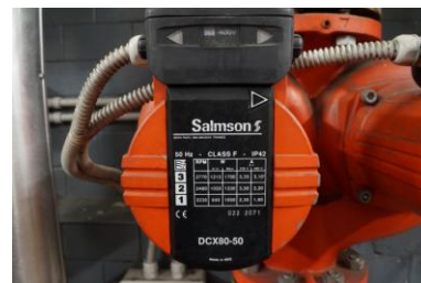
Figura 8.9 – Particolare pompe di circolazione
