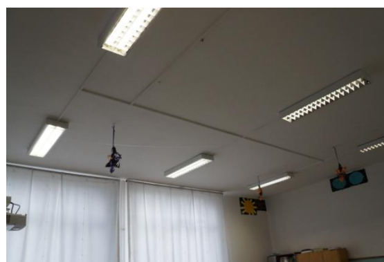
Figura 4.17 - Particolare dei corpi illuminanti ubicati nelle aule
