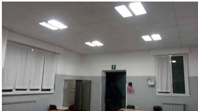
Figura 4.19 - Particolare dei corpi illuminanti ubicati nel refettorio
