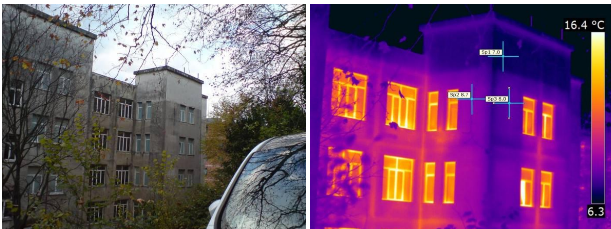
Figura 4.3 – Rilievo termografico della parete del fronte nord ovest
