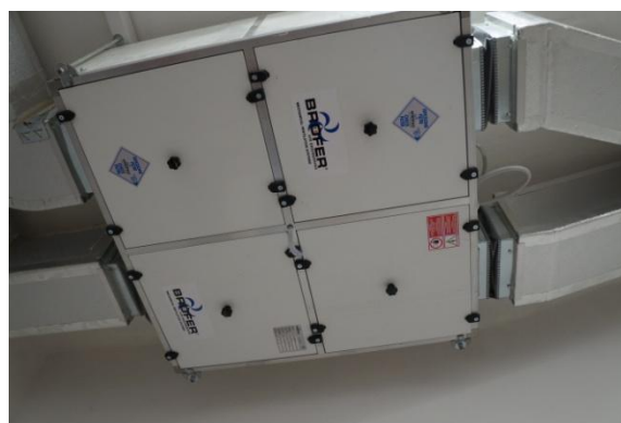
Figura 4.16 - Particolare del recuperatore di calore installato a soffitto
