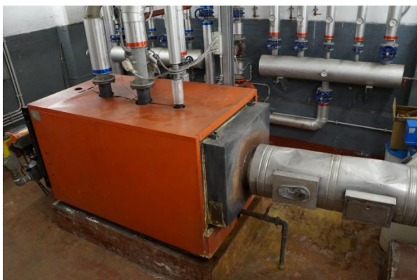
Figura 4.12 - Particolare del generatore di calore in CT
