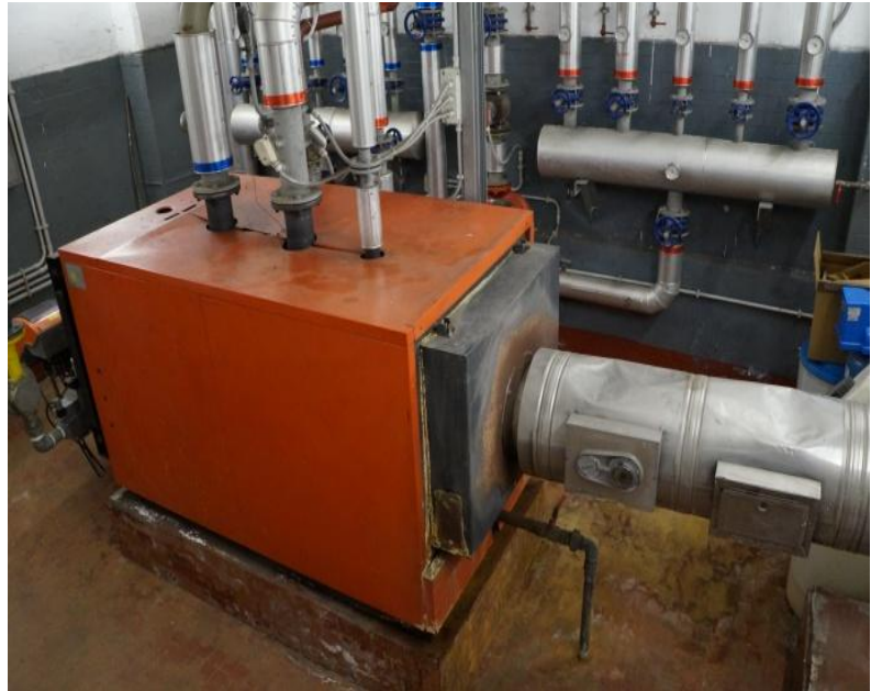
Figura 8.5 – Particolare della centrale termica
